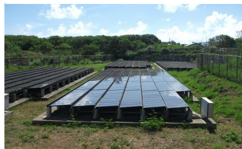
写真 4-10 太陽光発電実証実験設備
