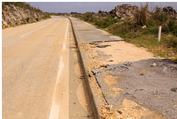
写真 4-17 台風により破壊された道路
